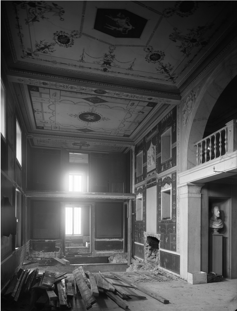
Fig. 12. Byströms villa 1906, under ombyggnad av interiören från 1840-talet. Foto: Nordiska museets arkiv, 65.J.i.
